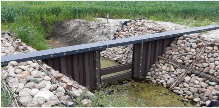
Zamknięcie szandorowe zainstalowane na obiekcie melioracyjnym Grabów nad Pilicą (woj. mazowieckie). Projekt INOMEL, fot. B. Kierasiński.
