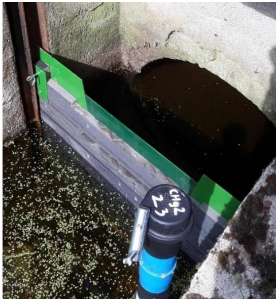
Zestaw przelewów na zastawkach melioracyjnych i przepustach z piętrzeniem
