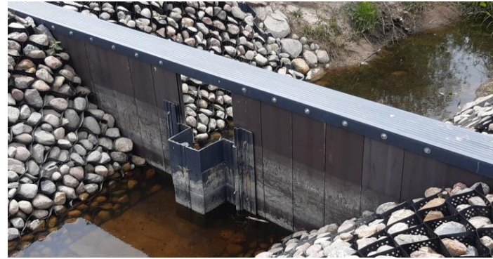
Zastawka U-kształtna obiekcie zainstalowane na obiekcie melioracyjnym Grabów nad Pilicą (woj. mazowieckie). Projekt INOMEL, fot. B. Kierasiński.
